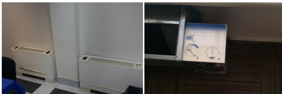
Figura 5-4 Shembuj të “fan coil-eve” të instaluar në ndërtesë; termostatat
