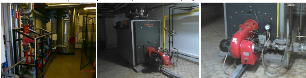
Figura 5-1 Shembuj të objekteve që shërbejnë për gjenerimin e nxehtësisë - stacione të ngrohjes qendrore; kaldaja; djegësi
