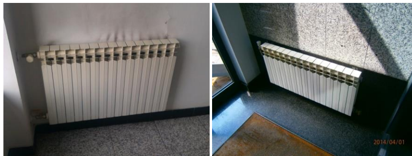
Figura 5-3 Shembuj të radiatorëve të instaluar në ndërtesë
